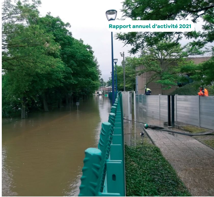
Barrières mobiles anti-crue pour maîtriser les inondations sur l'usine principale de Choisy-le-Roi.
