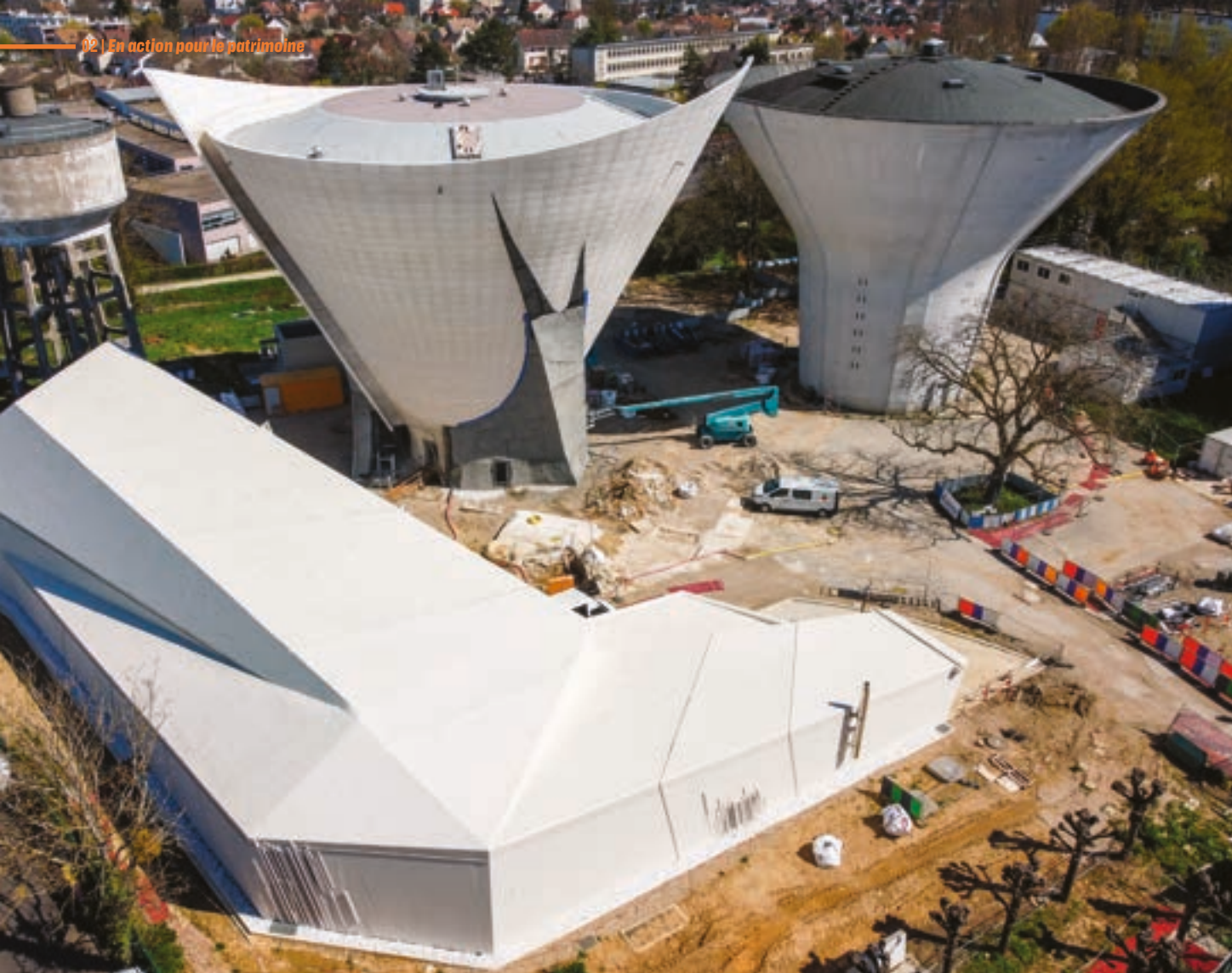
Création d'un nouveau réservoir et rénovation de la station de pompage de Palaiseau
